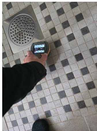
Bild 8: - Invändigt, Entréplan, Skvallerrör saknas under wc. Läckage på handfat. Inget uppvik på dörrtröskel. Inga förhöjda fuktv...
