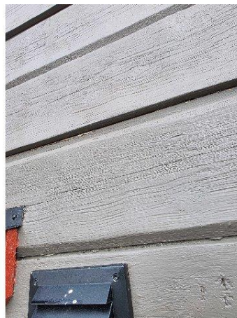
Bild 14: Utvändigt, Fasad, Torrprickor och mindre färgsläpp på fasad.
