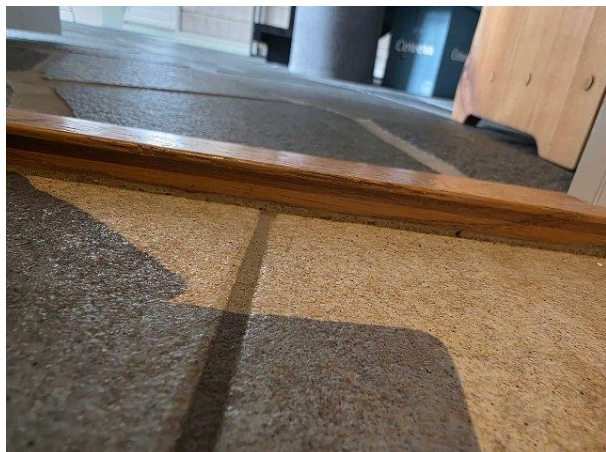
Bild 7: - Invändigt, Entréplan, Skvallerrör saknas under wc. Läckage på handfat. Inget uppvik på dörrtröskel. Inga förhöjda fuktv...
