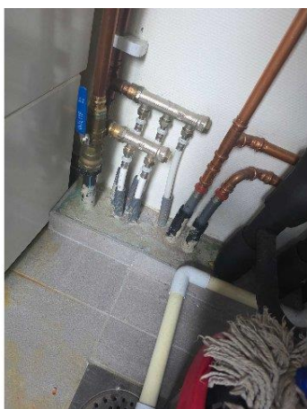
Bild 3: Invändigt, Entréplan, Troligen ett tidigare läckage under vvb då rost noterades på golv.
