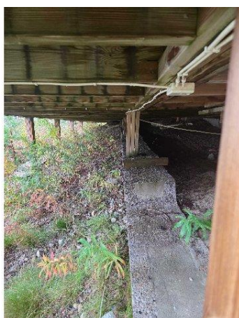
Bild 11: Utvändigt, Grundmur/Hussockel, Betongbalk under altan lutar/Sättningar.
