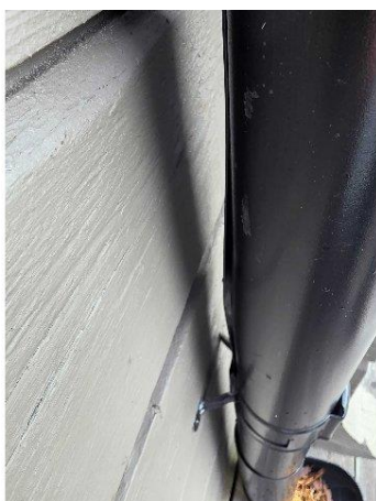
Bild 1: Utvändigt, Avvattningsrör. Frostsprängningar på stuprör.
