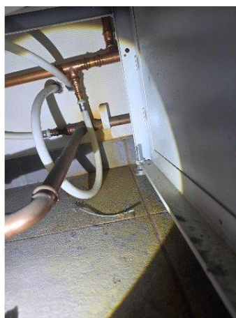
Bild 4: Invändigt, Entréplan, Troligen ett tidigare läckage under vvb då rost noterades på golv.
