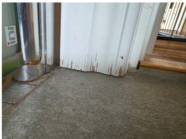
Bild 9: - Invändigt, Övervakning, Uppvik saknas på dörrtröskel. Skvallerrör saknas under wc. Inget våtrumsintyg uppvisades vid besi...
