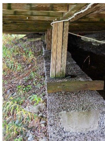
Bild 12: Utvändigt, Grundmur/Hussockel, Betongbalk under altan lutar/Sättningar.
