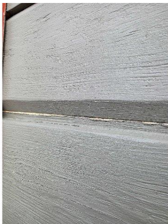
Bild 13: Utvändigt, Fasad, Torrprickor och mindre färgsläpp på fasad.
