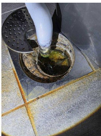
Bild 5: Invändigt, Entréplan, Troligen ett tidigare läckage under vvb då rost noterades på golv.
