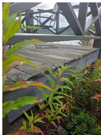
Bild 10: Utvändigt, Grundmur/Hussockel, Betongbalk under altan lutar/Sättningar.
