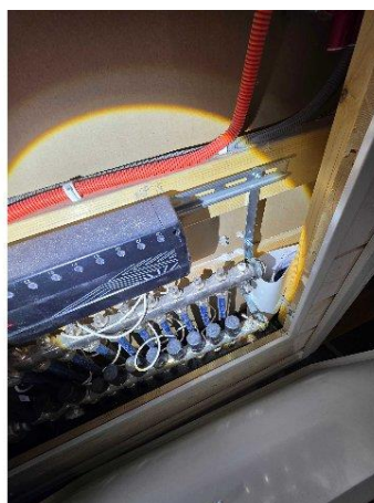
Bild 2: Invändigt, Entréplan, Fördelarskåp saknas till Golvvärmefördelare och uppfyller ej dagens krav på säkervatten.
