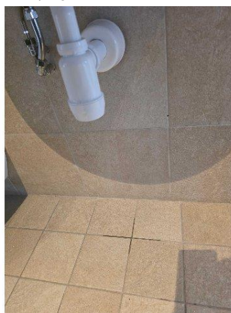
Bild 6: - Invändigt, Entréplan, Skvallerrör saknas under wc. Läckage på handfat. Inget uppvik på dörrtröskel. Inga förhöjda fuktv...
