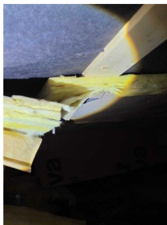
Bild 6: - Utvändigt, Grundmur/Hussockel, Isolering hänger..
