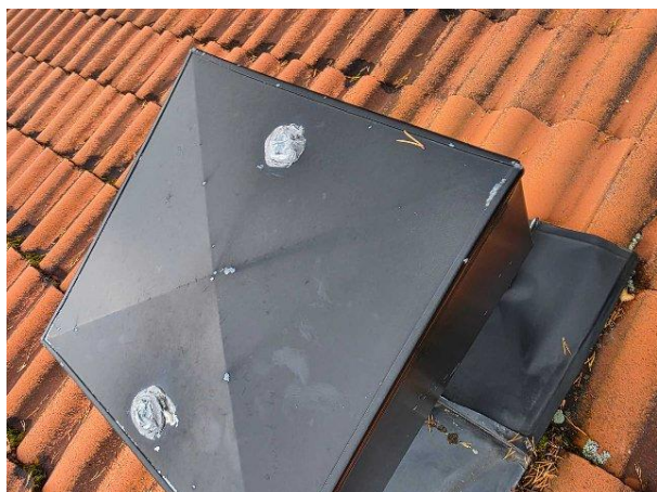
Bild 17: - Utvändigt, Yttertak, Äldre plåtar på tak.
