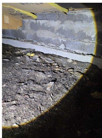
Bild 4: - Utvändigt, Grundmur/Hussockel, Krypgrund, Sprickor i grund.
