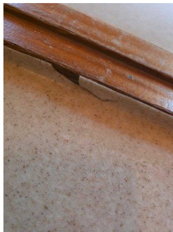
Bild 20: - Invändigt, Entréplan, Otäta rörgenomföringar i våtzon 1, golv.
