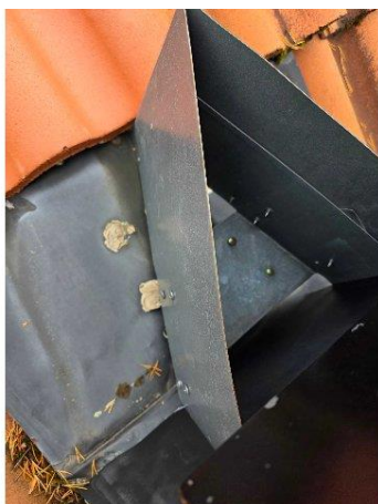
Bild 15: - Utvändigt, Yttertak, Äldre plåtar på tak.
