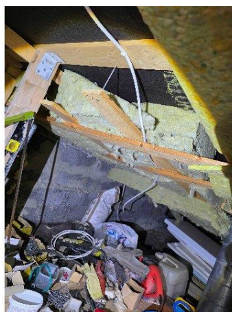
Bild 2: - Utvändigt, Grundmur/Hussockel, Isolering hänger.
