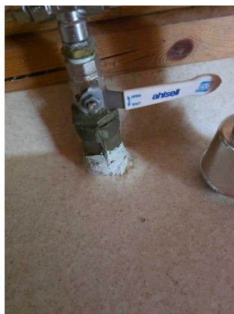
Bild 18: - Invändigt, Entréplan, Otäta rörgenomföringar i våtzon 1, golv.
