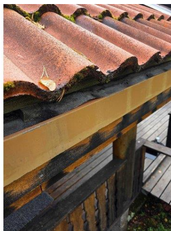
Bild 10: Utvändigt, Avvattning, Hängrännor och stuprör saknas
