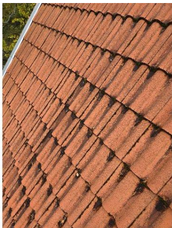
Bild 13: - Utvändigt, Yttertak, Mossa på tak.
