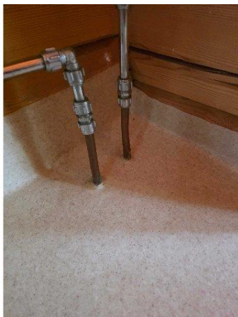
Bild 19: - Invändigt, Entréplan, Otäta rörgenomföringar i våtzon 1, golv.
