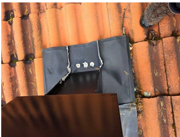
Bild 16: - Utvändigt, Yttertak, Äldre plåtar på tak..
