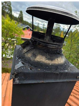
Bild 14: - Utvändigt, Yttertak, Äldre plåtar på tak.
