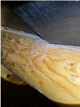
Bild 25: Invändigt, Entréplan, Tecken på läckage från skorsten.
