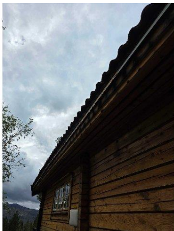
Bild 11: Utvändigt, Avvattning, Hängrännor och stuprör saknas
