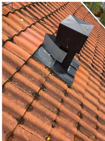
Bild 12: - Utvändigt, Yttertak, Mossa på tak. Äldre plåtar på tak. den tekniks livslängden på yttertaget har passerats.
