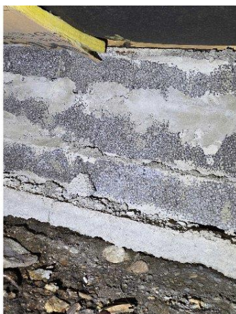
Bild 5: - Utvändigt, Grundmur/Hussockel, Krypgrund, Sprickor i grund.
