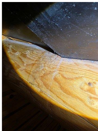
Bild 24: Invändigt, Entréplan, Tecken på läckage från skorsten.
