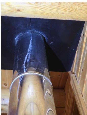
Bild 23: Invändigt, Entréplan, Tecken på läckage från skorsten.
