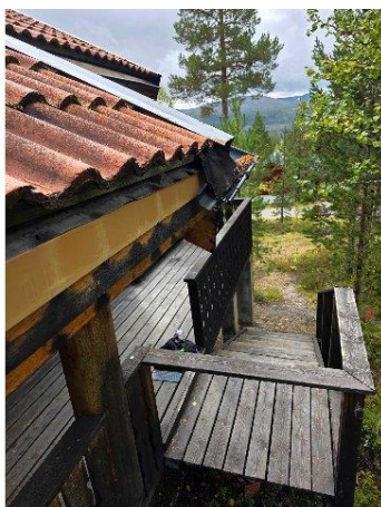
Bild 9: Utvändigt, Avvattning, Hängrännor och stuprör saknas
