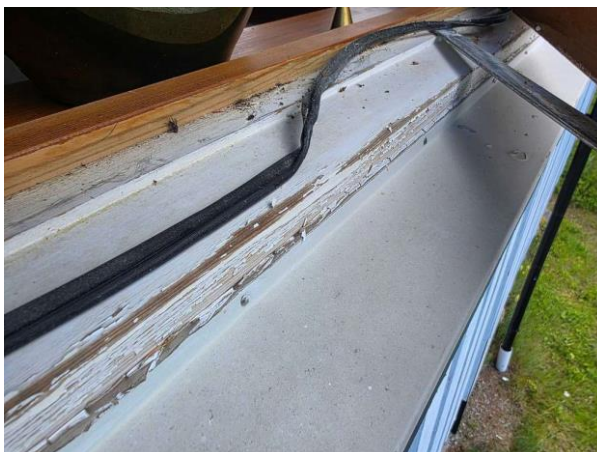
Bild 4: - Utvändigt, Fönster, Isolerglas är äldre än 20 år. Torrprickor och färgsläpp på fönster.
