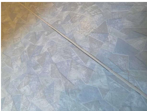
Bild 12: - Invändigt, Källarplan, Äldre tät och ytskickt. Öppna mattskarvar på golv. Fuktmärken på vägg vid ventil. Otäta rör genom...
