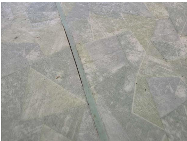
Bild 14: - Invändigt, Källarplan, Äldre tät och ytskickt. Öppna mattskarvar på golv. Fuktmärken på vägg vid ventil. Otäta rör genom...
