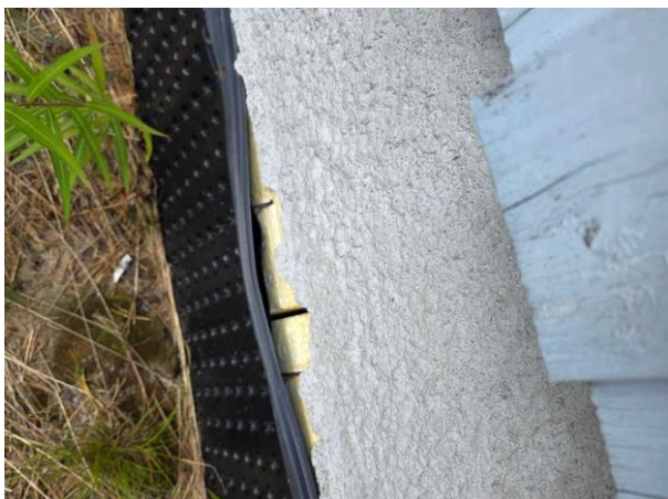
Bild 3: Utvändigt, Fasad, Torrprickor i fasad.
