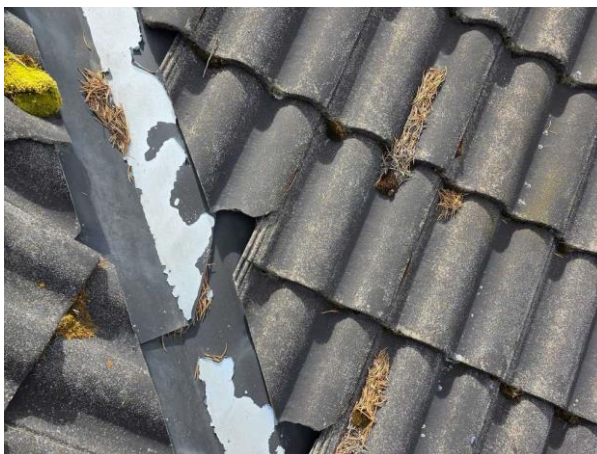
Bild 10: - Utvändigt, Yttertak, Mossa på tak. Trasiga takpannor i ränndalar och takfot. Fel längd på pannspik, spiken har gjort h...
