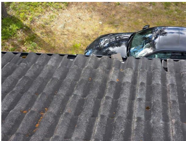
Bild 8: - Utvändigt, Yttertak, Mossa på tak. Trasiga takpannor i ränndalar och takfot. Fel längd på pannspik, spiken har gjort h...
