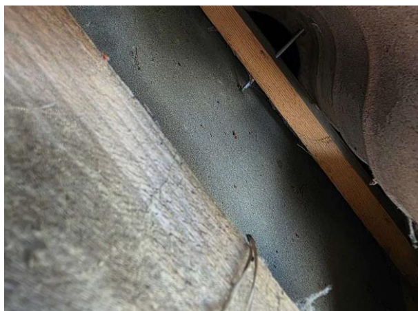
Bild 11: - Utvändigt, Yttertak, Mossa på tak. Trasiga takpannor i ränndalar och takfot. Fel längd på pannspik, spiken har gjort h...
