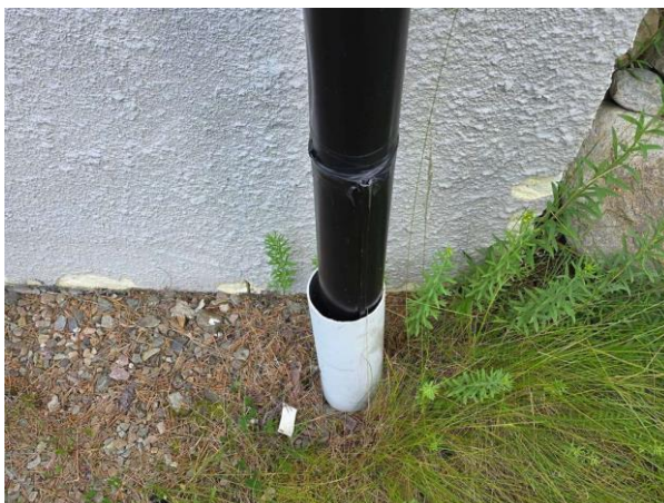
Bild 6: Utvändigt, Avvattning, Lösilar saknas på stuprör
