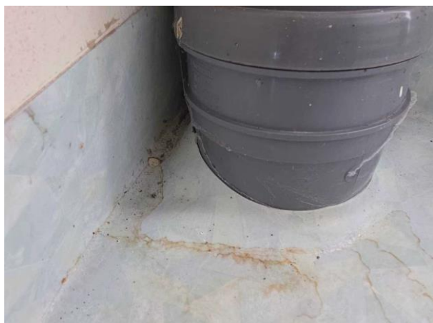
Bild 15: - Invändigt, Källarplan, Äldre tät och ytskickt. Öppna mattskarvar på golv. Fuktmärken på vägg vid ventil. Otäta rör genom...
