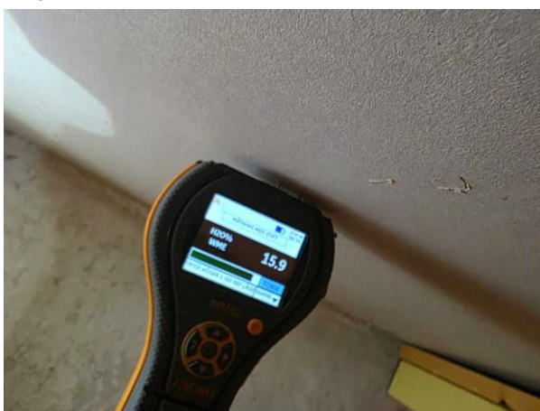
Bild 18: - Invändigt, Källarplan, Någon avvikande lukt noterades. Något förhöjda fuktvärden i källarvägg, Uppmätta fuktvärden 15,9- ...
