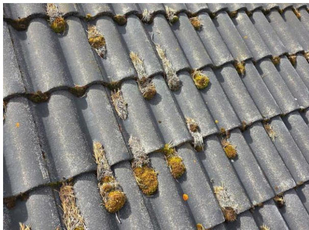
Bild 7: - Utvändigt, Yttertak, Mossa på tak. Trasiga takpannor i ränndalar och takfot. Fel längd på pannspik, spiken har gjort h...
