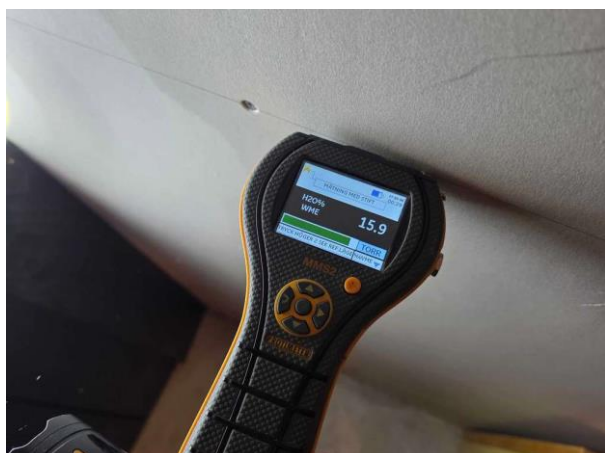
Bild 19: - Invändigt, Källarplan, Någon avvikande lukt noterades. Något förhöjda fuktvärden i källarvägg, Uppmätta fuktvärden 15,9-...
