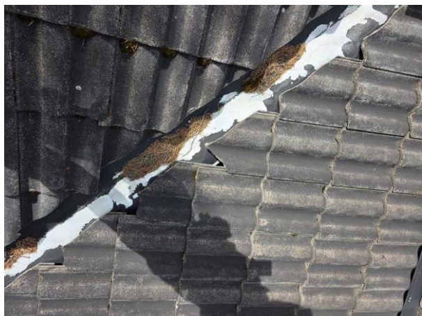
Bild 9: - Utvändigt, Yttertak, Mossa på tak. Trasiga takpannor i ränndalar och takfot. Fel längd på pannspik, spiken har gjort h...
