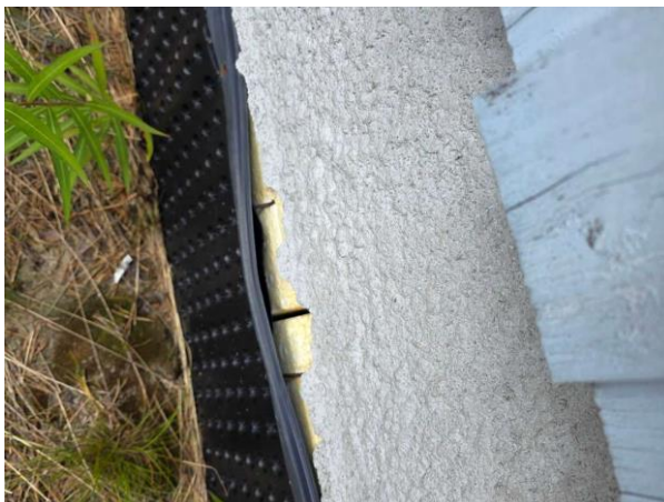
Bild 2: Utvändigt, Grundmur/Hussockel, En del inklädnader förekommer i källarplanet, se riskanalys Platonmatta glipar mot grunden.
