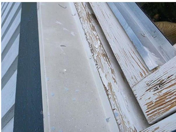
Bild 5: - Utvändigt, Fönster, Isolerglas är äldre än 20 år. Torrprickor och färgsläpp på fönster.
