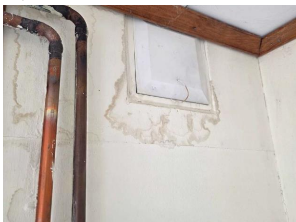
Bild 17: - Invändigt, Källarplan, Äldre tät och ytskickt. Öppna mattskarvar på golv. Fuktmärken på vägg vid ventil. Otäta rör genom...
