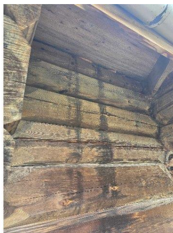
Bild 18: - Utvändigt, Fasad, Kondensvatten från lvp leds ej bort från grund. Fasad blek. Rinnmärken på fasad vid altan men ing...
