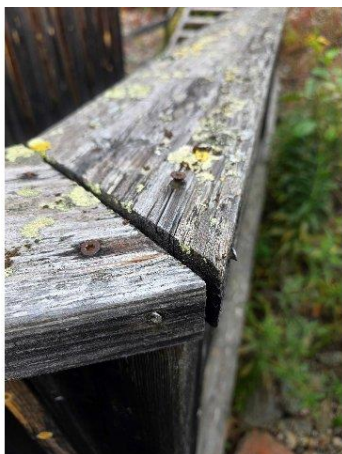
Bild 15: Utvändigt, Övrigt, Rötskador/sättningar på altan och rötskador på räcket.
