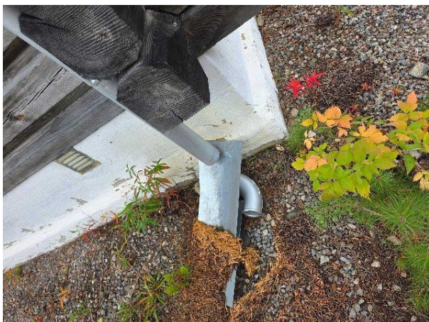
Bild 11: - Utvändigt, Avvattning, Stående vatten i hängrännor. Frostsprängningar på stuprör.
