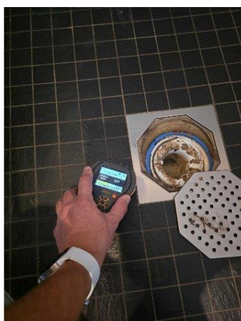
Bild 23: - Invändigt, Entréplan, Lösa klinkerplattor vid bastudörr. Bomljud under klinkerplattor. Inget uppvik. Endast lokalt fall...
