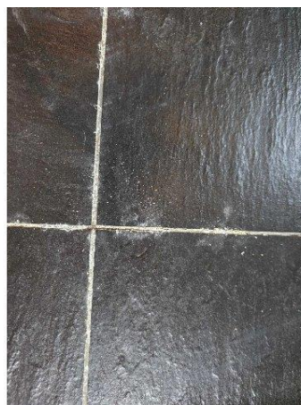
Bild 22: - Invändigt, Entréplan, Lösa klinkerplattor vid bastudörr. Bomljud under klinkerplattor. Inget uppvik. Endast lokalt fall...
