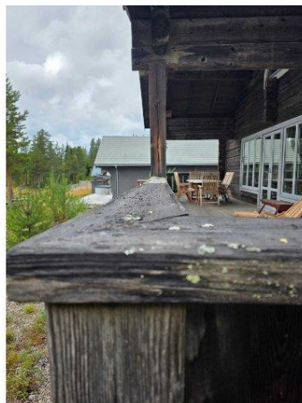
Bild 14: Utvändigt, Övrigt, Rötskador/sättningar på altan och rötskador på räcket.
