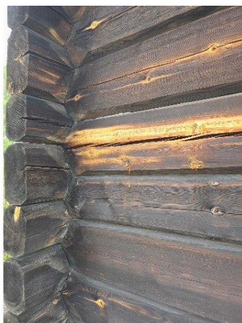
Bild 17: - Utvändigt, Fasad, Kondensvatten från lvp leds ej bort från grund. Fasad blek. Rinnmärken på fasad vid altan men ing...
