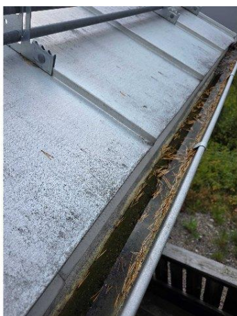
Bild 1: - Utvändigt, Avvattning, Stående vatten i hängrännor. Frostsprängningar på stuprör.
