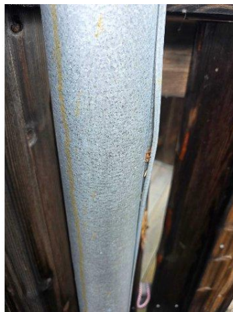
Bild 8: - Utvändigt, Avvattning, Stående vatten i hängrännor. Frostsprängningar på stuprör.
