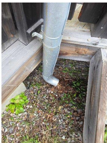
Bild 9: - Utvändigt, Avvattning, Stående vatten i hängrännor. Frostsprängningar på stuprör.
