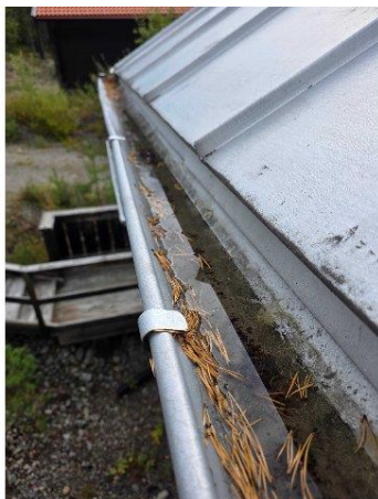
Bild 13: - Utvändigt, Avvattning, Stående vatten i hångrännor. Frostsprängningar på stuprör.
