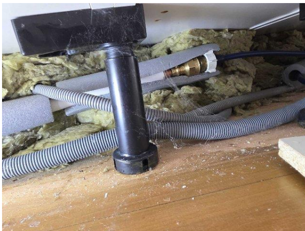
Bild 20: - Invändigt, Entréplan, Läckage på vattenslang till diskmaskin. (Torrt vid besiktningstillfället) Otäta rörgenomföringar ...
