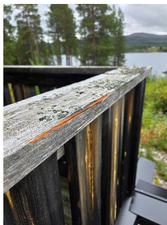
Bild 10: Utvändigt, Övrigt, Rötskador/sättningar på altan och rötskador på räcket.
