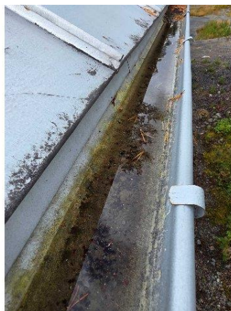
Bild 12: - Utvändigt, Avvattning, Stående vatten i hängrännor. Frostsprängningar på stuprör.
