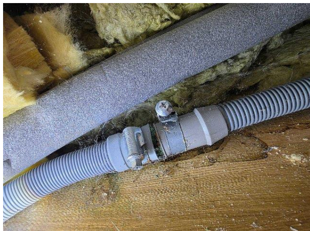
Bild 19: - Invändigt, Entréplan, Läckage på vattenslang till diskmaskin. (Torrt vid besiktningstillfället) Otäta rörgenomföringar ...
