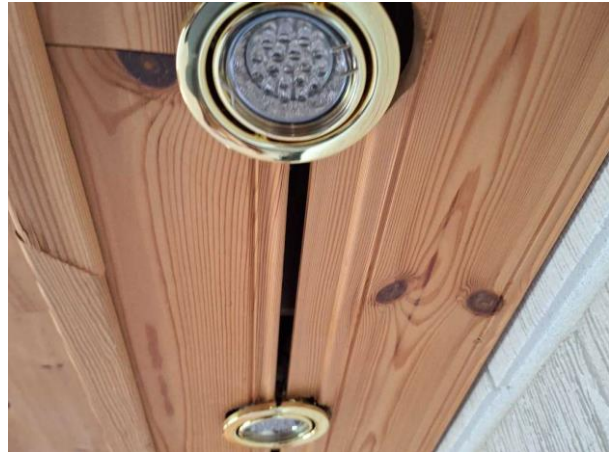
Bild 20: Vardagsrum, Panel glipar i tak.
