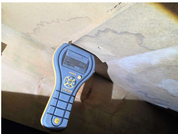
Bild 7: - Utvändigt, Grundmur/Hussockel, Krypgrund, se riskanalys. Påväxt på trossbottenskivor.
