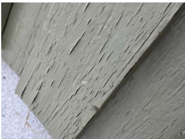
Bild 9: Utvändigt, Fasad, Fasad flammig med färgsläpp mot söder.
