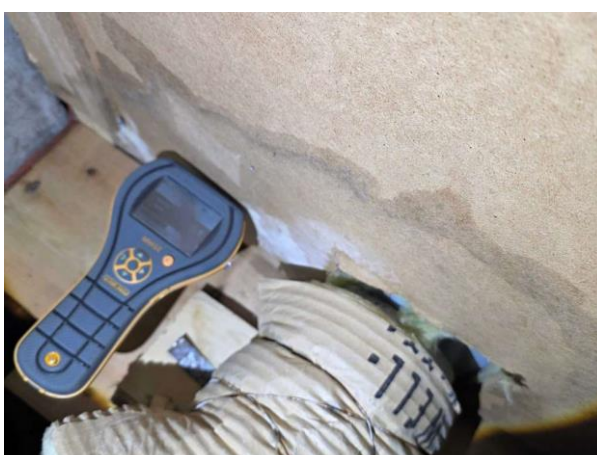
Bild 6: - Utvändigt, Grundmur/Hussockel, Täcken på läckage under badrum med påväxt...
