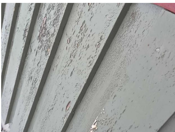
Bild 11: Utvändigt, Fasad, Fasad flammig med färgsläpp mot söder.
