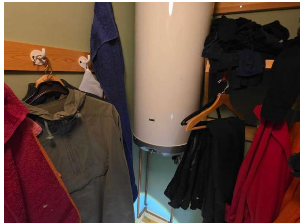
Bild 18: Invändigt, Entréplan, Varmvattenberedare placerad i utrymme utan tätskikt och golvbrunn.
