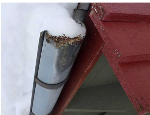
Bild 12: - Utvändigt, Avvattning.. Barr och löv i hängrännor.
