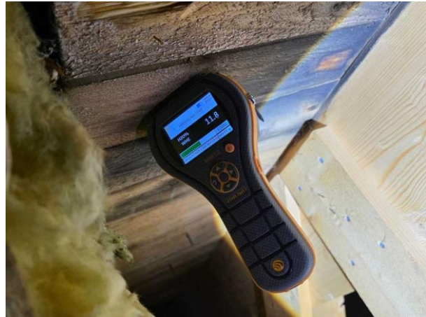
Bild 14: Utvändigt, Vind, Fuktmärken runt Skorstensgenomföringar. Inga förhöjda fuktvärden uppmättes
