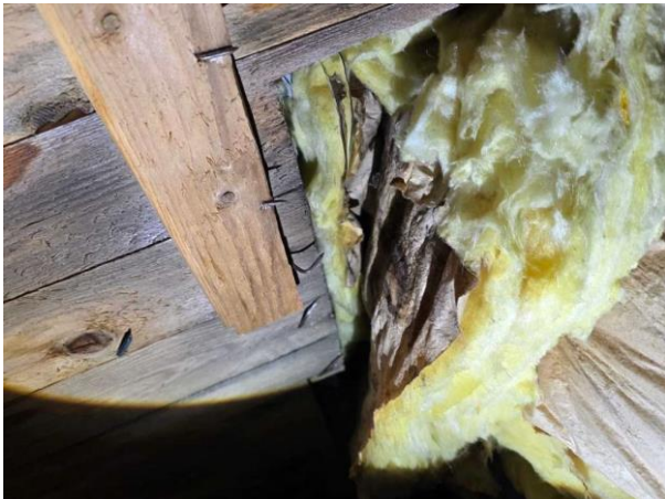
Bild 15: Utvändigt, Vind, Fuktmärken runt Skorstensgenomföringar. Inga förhöjda fuktvärden uppmättes.
