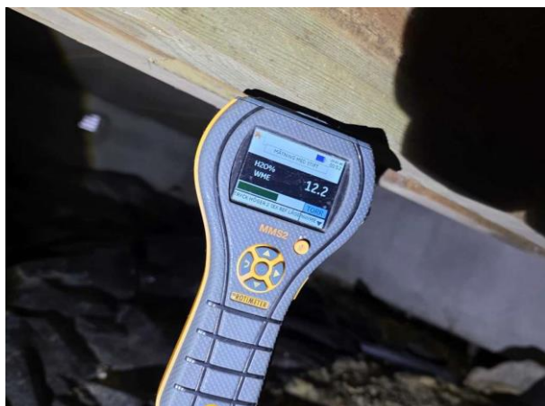
Bild 1: - Utvändigt, Grundmur/Hussockel. Påväxt på trossbottenskivor.
