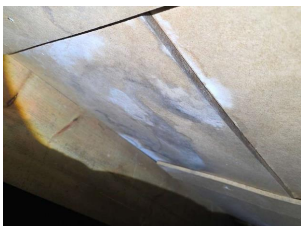
Bild 5: - Utvändigt, Grundmur/Hussockel, Täcken på läckage under badrum med påväxt...
