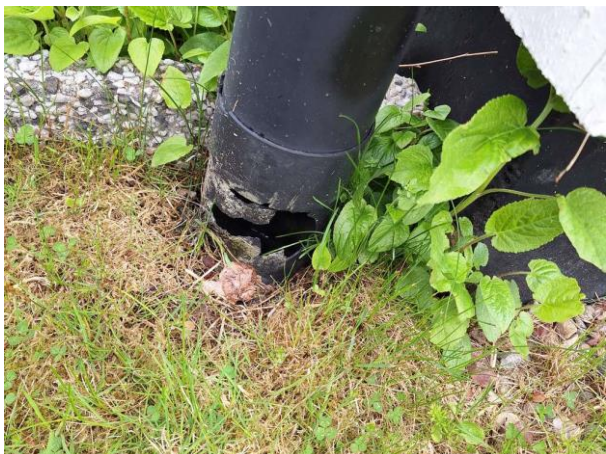
Bild 7: - Utvändigt, Avvattning, Mossa och löv i hängrännor. Läckage på hängrännor. Rännstopp saknas vid garage. Stuprör leds ej b...
