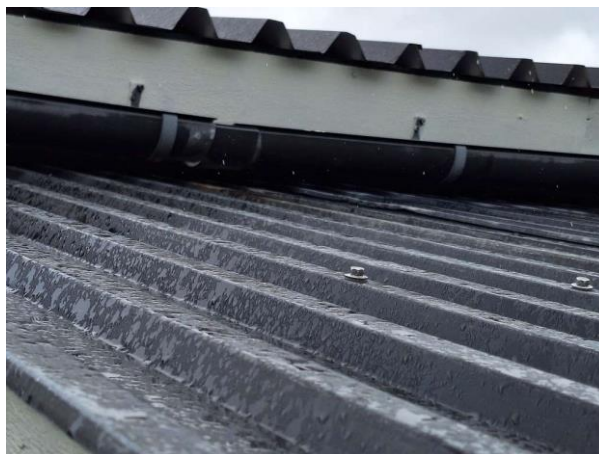
Bild 4: - Utvändigt, Avvattning, Mossa och löv i hängrännor. Läckage på hängrännor. Rännstopp saknas vid garage. Stuprör leds ej b...
