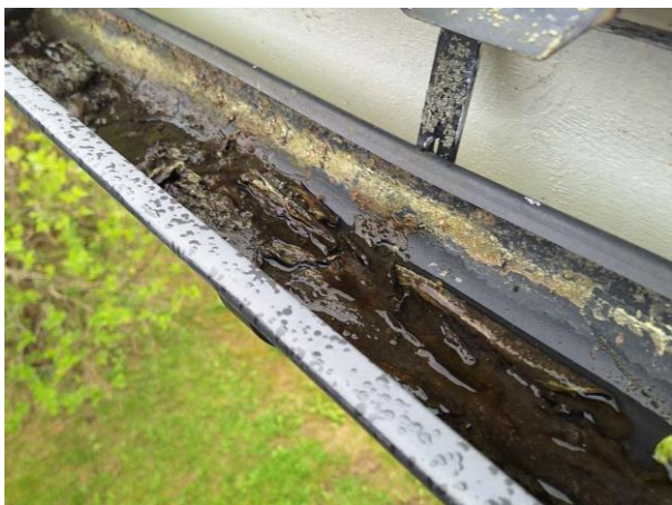
Bild 3: - Utvändigt, Avvattning, Mossa och löv i hängrännor. Läckage på hängrännor. Rännstopp saknas vid garage. Stuprör leds ej b...
