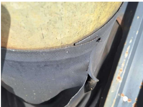
Bild 15: - Utvändigt, Yttertak, Skarv runt skorsten har släppt.
