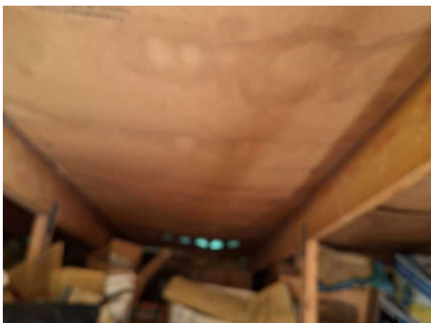
Bild 11: - Utvändigt, Vind, Fuktmärken på masonit Masoniten över garaget har släppt och hänger ner.
