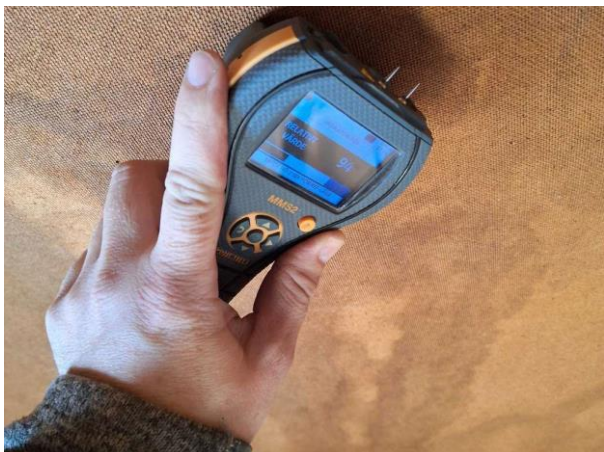
Bild 13: - Utvändigt, Vind, Fuktmärken på masonit Masoniten över garaget har släppt och hänger ner. Inga förhöjda fuktvärden uppmättes vid besiktningstillfället...
