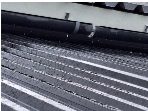
Bild 5: - Utvändigt, Avvattning, Mossa och löv i hängrännor. Läckage på hängrännor. Rännstopp saknas vid garage. Stuprör leds ej b...
