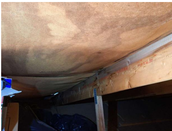
Bild 10: - Utvändigt, Vind, Fuktmärken på masonit Masoniten över garaget har släppt och hänger ner.
