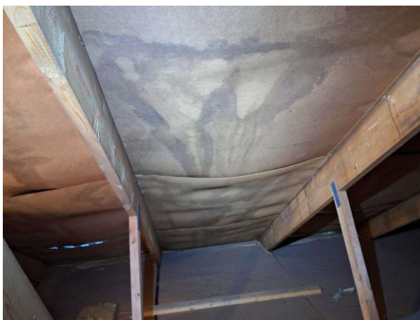
Bild 12: - Utvändigt, Vind, Fuktmärken på masonit Masoniten över garaget har släppt och hänger ner.
