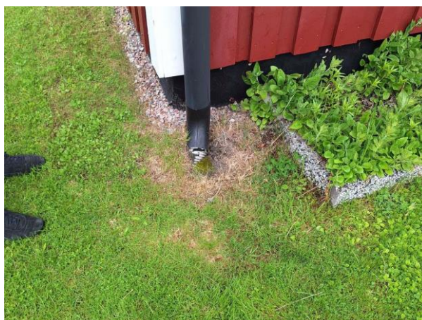
Bild 6: - Utvändigt, Avvattning, Mossa och löv i hängrännor. Läckage på hängrännor. Rännstopp saknas vid garage. Stuprör leds ej b...
