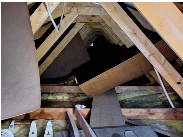
Bild 9: - Utvändigt, Vind, Fuktmärken på masonit Masoniten över garaget har släppt och hänger ner.
